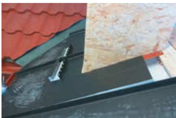
Obr. c – Po odštípnutí vnější strany zámků první šablony v místě příčného přeložení s druhou šablonou se šablona uchytí nerezovými šrouby a osadí se větrací profily.
