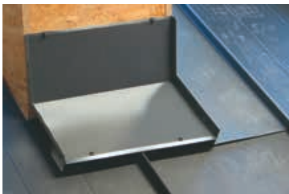
Obr. e – Osazení čelního oplechování z hladkého plechu a jeho uchycení k větracím profilům a zafalcování k druhé šabloně.
