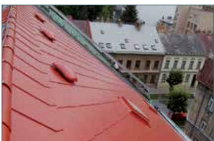
Větrání střešního pláště je realizováno plastovými hlavicemi.
